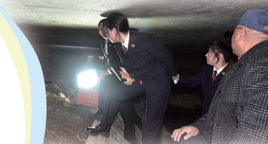
2024年11月13日，青岛市李沧区检察院办案检察官深入铁路涵洞查看排污管道整改情况。
