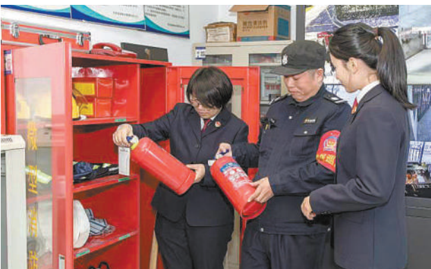
近日,张家港市检察院在开展检察建议“回头看”过程中,联合消防控制室值班操作人员对火灾报警控制器、灭火器等消防设备进行查看。
