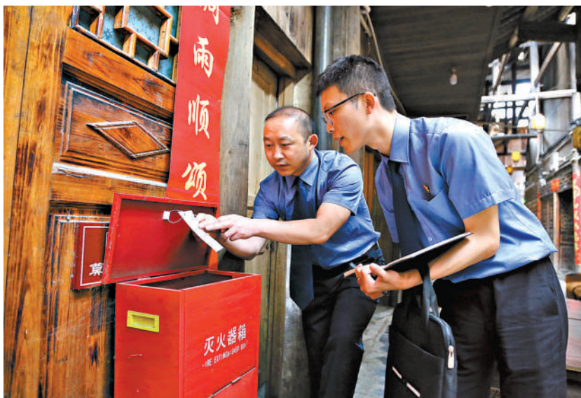
湖北省宣恩县检察院公益诉讼办案组在庆阳坝村对消防设施完善情况进行“回头看”,发现消防器材安装效果良好,管理制度健全,安全隐患已经消除。郑昕摄
