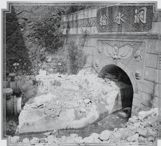
▲赵湾水库输水洞被违建水电站阻塞时的景象
