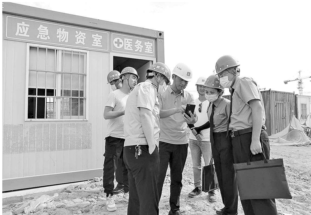
近日，江苏省宿迁市宿城区检察院检察官与区应急管理局工作人员对辖区内建筑工地危险气体储存、使用情况开展专项检查，并提出整改意见，帮助企业消除安全隐患，共筑安全生产防线。
