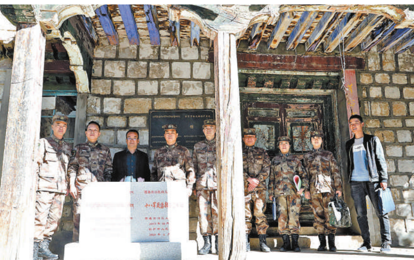
拉萨军事检察院检察官到十八军政治部办公旧址修复现场勘查。农仕凯摄
