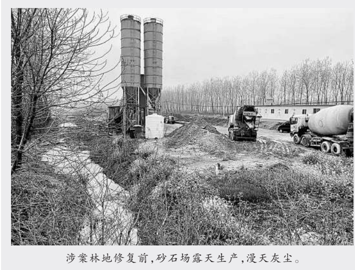
涉案林地修复前,砂石场露天生产,漫天灰尘。
