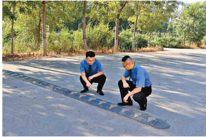
今年7月,庆云县公益诉讼检察官实地勘查减速带损坏情况。
