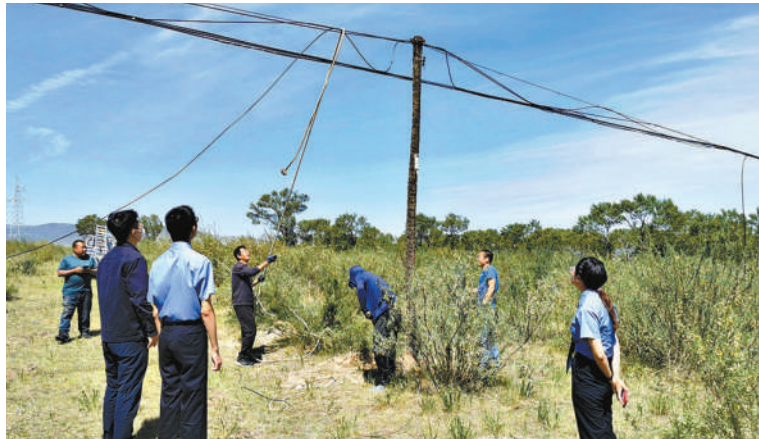
今年8月17日,新荣区检察院检察官受邀参与倾斜电线杆整改工作。图为郭家窑乡北温窑村一处倾斜电线杆整改现场。
