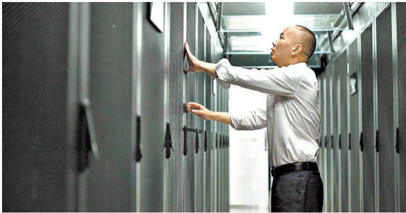
刘海江在西藏自治区检察机关的机房进行安全检查。
