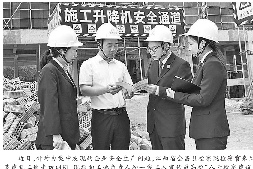
近日,针对办案中发现的企业安全生产问题,江西省会昌县检察院检察官来到某建筑工地走访调研,现场向工地负责人和一线工人宣传最高检“八号检察建议”有关内容,督促做好安全生产工作。 本报通讯员 尹新月 姚卫东 摄
