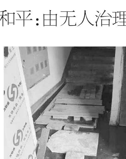
整改前:楼道污水外溢,居民出入需要踩着污水中铺垫的砖块。
