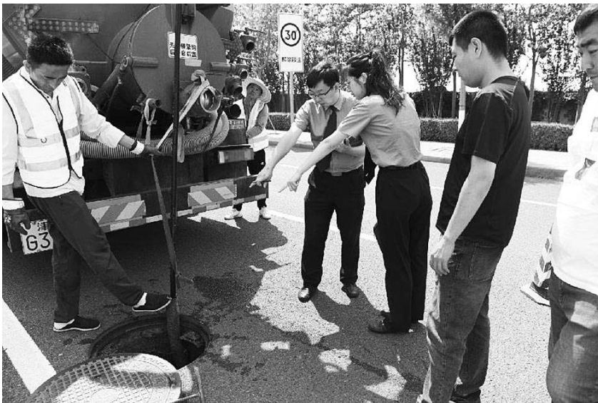
近日,天津市西青区检察院聚焦窨井盖安全隐患开展公益诉讼专项监督。图为检察干警对窨井盖存在的安全隐患进行排查,并及时督促有关部门修整问题窨井盖,守护群众“脚下安全”。
