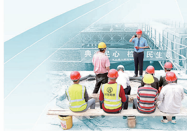
5月16日，江西省玉山县检察院检察官来到位于该县紫湖镇的枫叶大桥施工现场，开展“典润民心 检护民生”普法活动，向务工人员详细介绍民法典有关知识、民事支持起诉职能等。 本报通讯员罗宥 姚卫东摄
