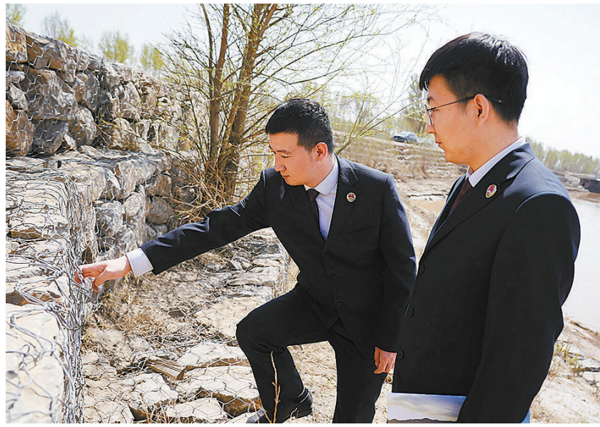
今年4月,内蒙古自治区托克托县检察院公益诉讼检察官再次来到黄河岸边,对堤坝修复情况进行“回头看”。 本报通讯员魏奇摄
