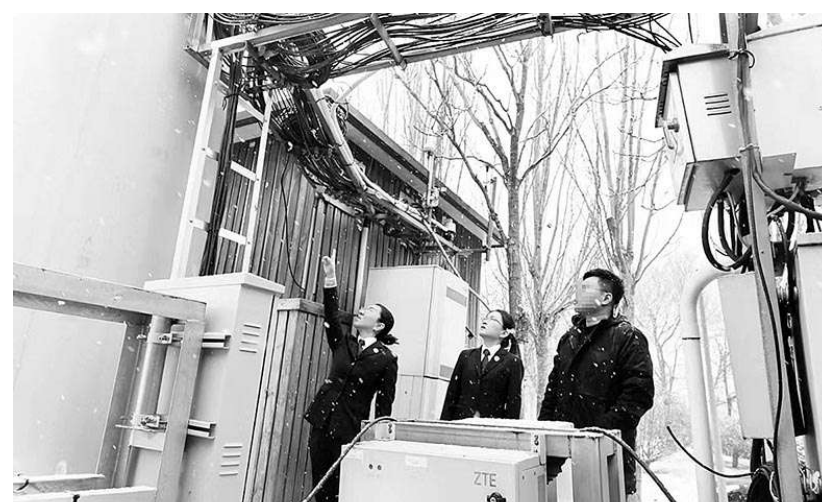
1月中旬,天津市河西区检察院聚焦安全生产领域履行公益诉讼检察职能,根据该院“益心为公”检察云平台志愿者提供的线索,对辖区居民小区大量管线裸露问题立案调查。图为近日检察官联合相关单位负责人对管线裸露问题整改情况进行回访。 本报记者陶强 通讯员王厚涛摄
