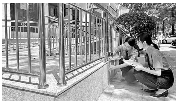
近日,湖南省衡阳市南岳区检察院开展“回头看”活动,实地查看辖区部分公共服务场所无障碍坡道建设不规范问题的整改落实情况。 本报通讯员谢凤摄
