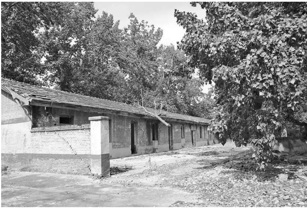
通州兵营旧址整改前,落叶堆积,树木缺乏维护。
